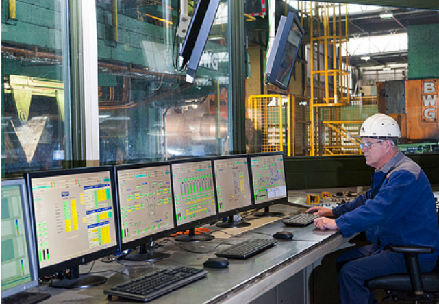
Sala de control
