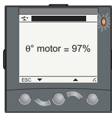
Alarma de imagen térmica.
