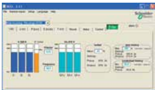
Pantalla de PC con imagen térmica del motor y supervisión del valor.
