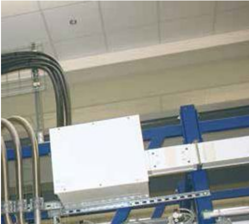
Canalis KS and sprinkler.
