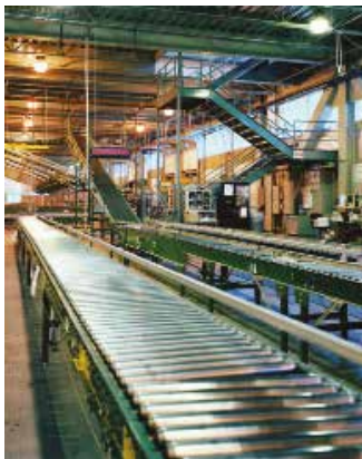
Aplicación de manipulación de materiales
