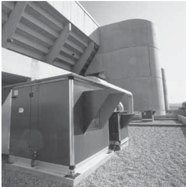
Aplicación de tratamiento del aire
