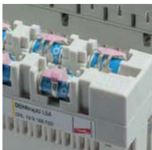
Tubos de descarga de gas con indicación de fallo óptica y función a prueba de fallos.
