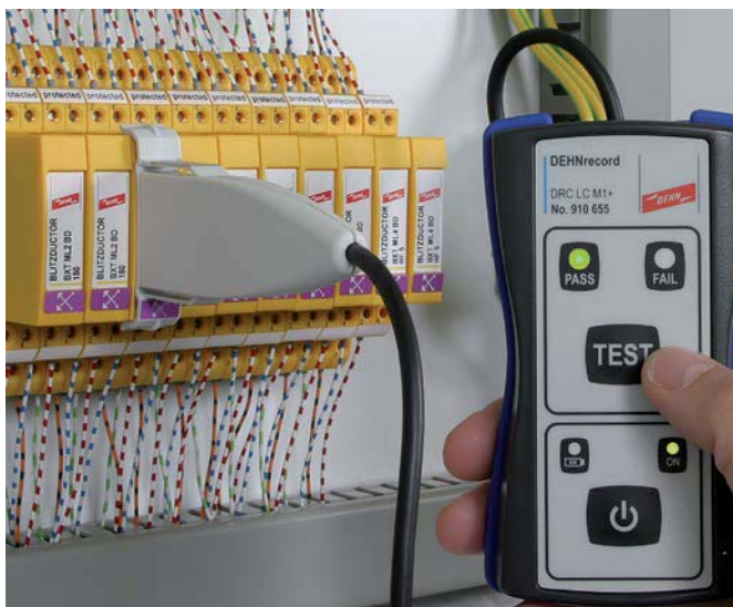
Verificación de un módulo de descargador con técnica RFID (LifeCheck)
