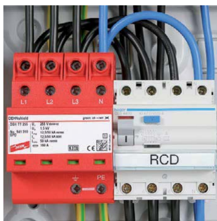
Cableado con borna de conexión STAK 25 probada contra corriente de rayo.
