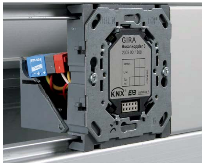
Protección de una unidad de acoplamiento de bus KNX por medio del descargador de sobretensiones BUSector montado sobre un terminal de bus en el panel de montaje de la conducción de cables.
