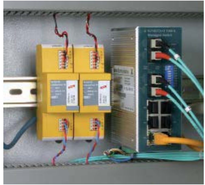
Protección de las salidas del altavoz de un sistema de alarma vocal.
